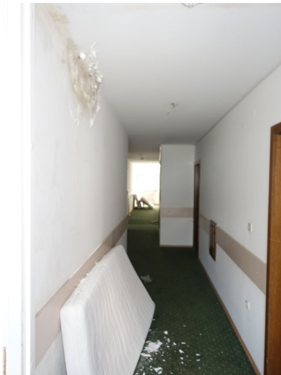
Gangbereich Gästezimmer Feuchteschäden
