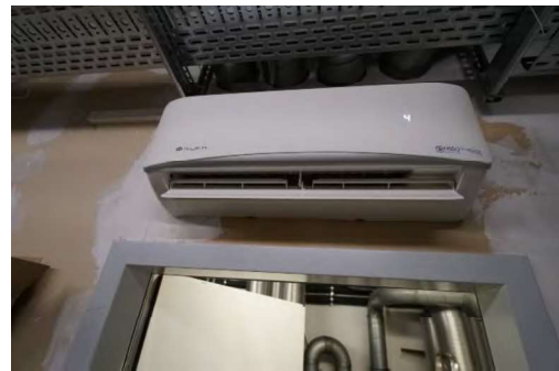
Keller Technik – Server/EDV
