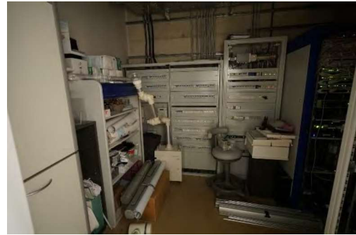
Keller Technik – Server/EDV
