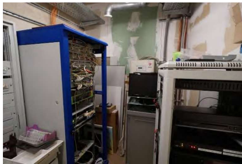
Keller Technik – Server/EDV
