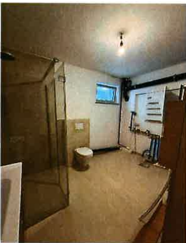
Foto 15: Kellergeschoß Technik & Bad Haus Top 2
