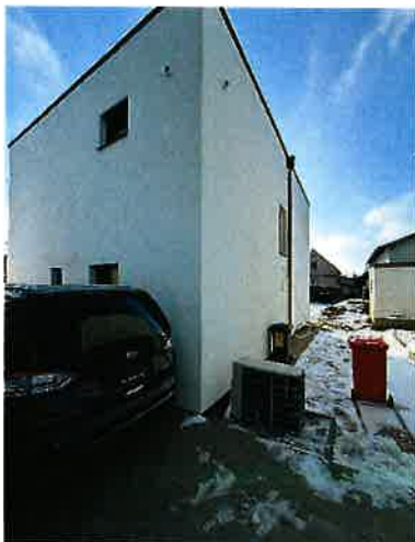
Foto 35: Luft/Wasserwärmepumpe Haus Top 1
