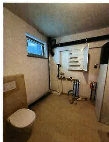
Foto 16: Kellergeschoß Technik & Bad Haus Top 2
