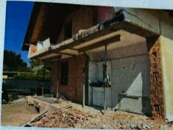
Abb. 1: Ansicht aus dem Süden: Entfernte tragende Außenwände des EG, Rissbildung Geschoßdecke zu Mauerbank, mangelhafte Unterstellung der Geschoßdecke, Position der neuen Außenwände verändert.
