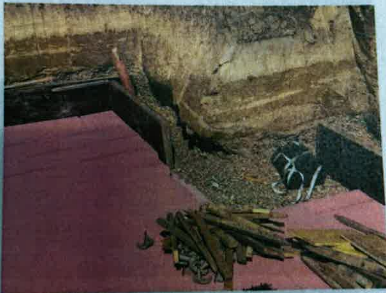
Abb.4: Baugrube an der nördlichen Ecke: Geländebruch des Untergrunds, fehlende Sicherung der Böschung und des Erdreichs gegen auswaschen.
