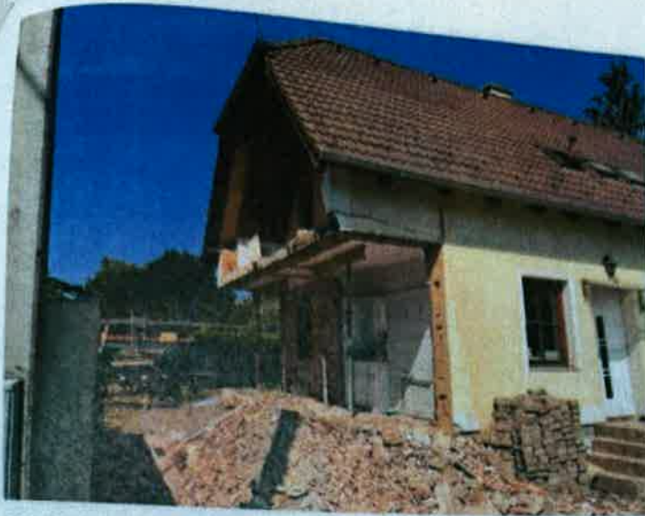
Abb. 3: Ansicht aus dem Süden: Entfernte tragende Außenwände des EG und OG. Rissbildung Geschoßdecke zu Mauerbank, mangelhafte Unterstellung der Geschoßdecke. Position der neuen Außenwände verändert, fehlende Auflage der Mittelpfetten.
