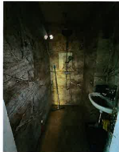
Foto 16: Bad EG Bestandsgebäude
