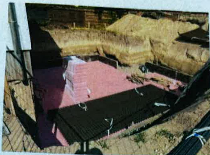
Abb. 5: Ansicht der Baugrube Richtung Norden: Geländebruch des Untergrunds, fehlende Sicherung der Böschung und des Erdreichs gegen auswaschen, fehlende Absturzsicherung.
