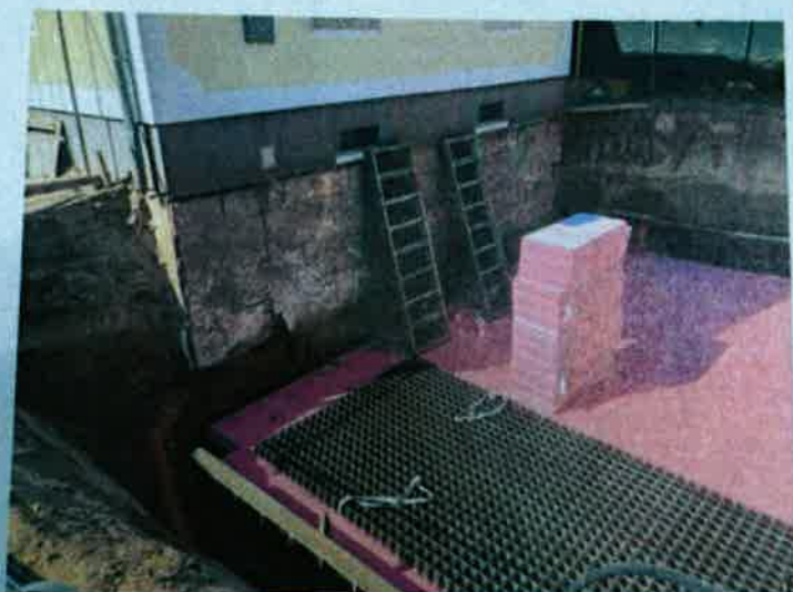
Abb. 6: Ansicht der Baugrube Richtung Bestandsgebäude: Fehlende Unterfangung des Bestandsgebäudes, fehlende Sicherung der Böschung und des Erdreichs gegen auswaschen.
