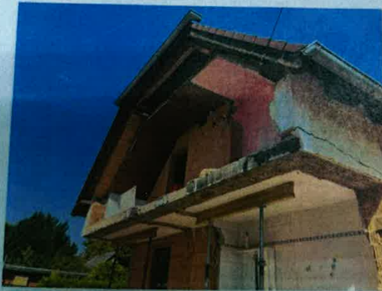
Abb. 2: Ansicht aus dem Süden: Entfernte tragende Außenwände des OG, Rissbildung Geschoßdecke zu Mauerbank, Position der neuen Außenwände verändert, fehlende Auflage der Mittelpfetten.
