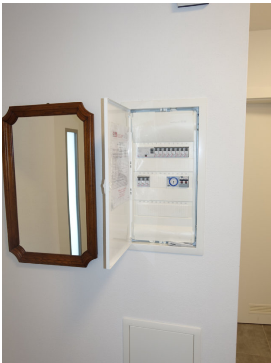
Wohnung Top W01, E-Subverteiler
