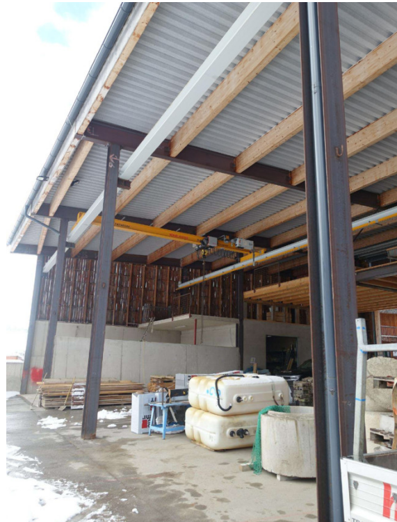
Haustechnik Bürotrakt UG
