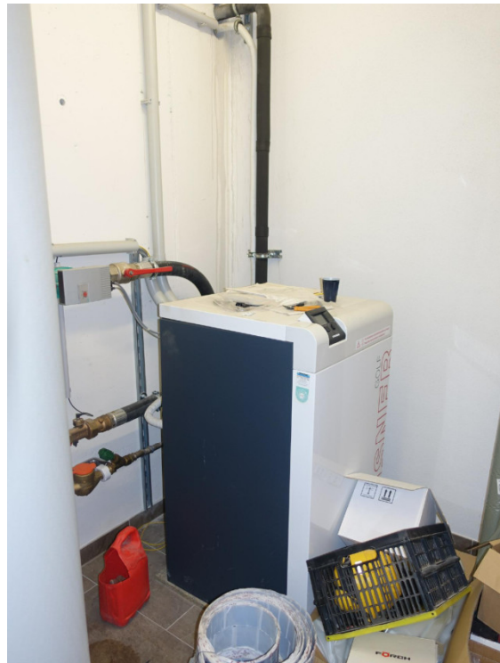
Heizraum / Bürotrakt UG
