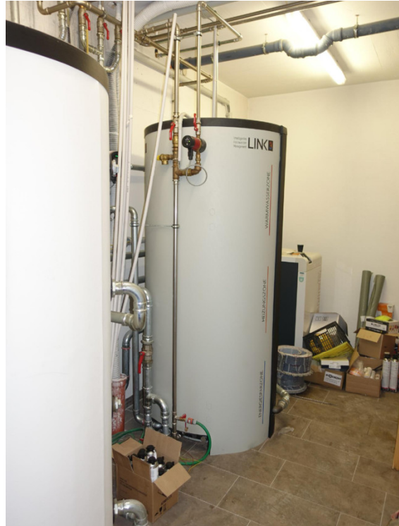
Haustechnik Bürotrakt UG
