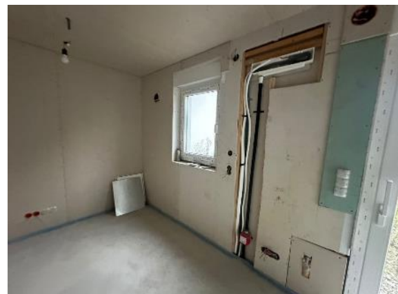
Foto 12: Küchenanschlüsse im Ausbaurzustand
