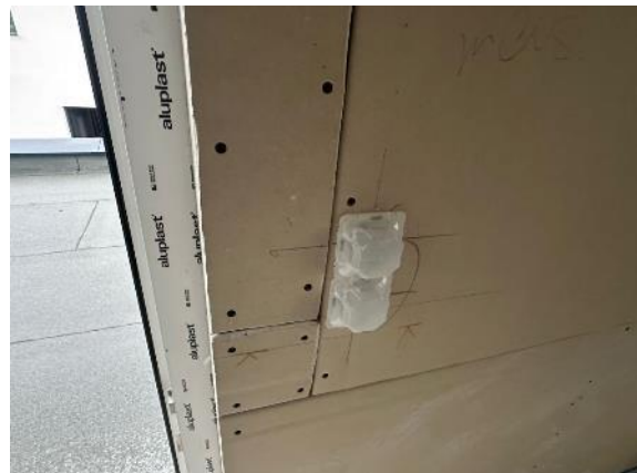
Foto 4: Unterputzdosen für Lichtschalter
