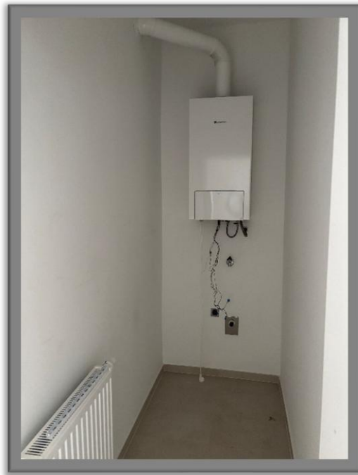
Foto 32: Top 12 – Abstellraum – Therme
