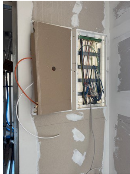
1.OG Top 3 - Verteiler
