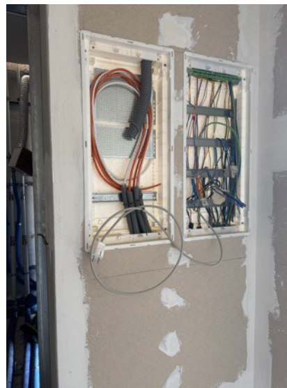
2.OG Top 7 - Verteiler
