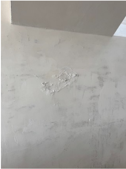
DG Top 9 – Wohnküche, Feuchtigkeitsschaden
