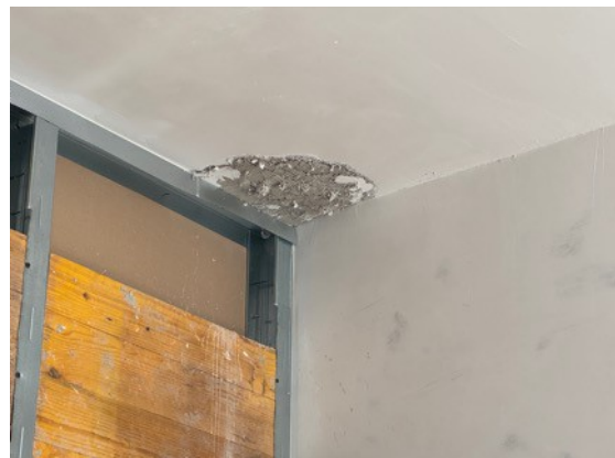
Erdgeschoss Top 2 – Schaden Decke
