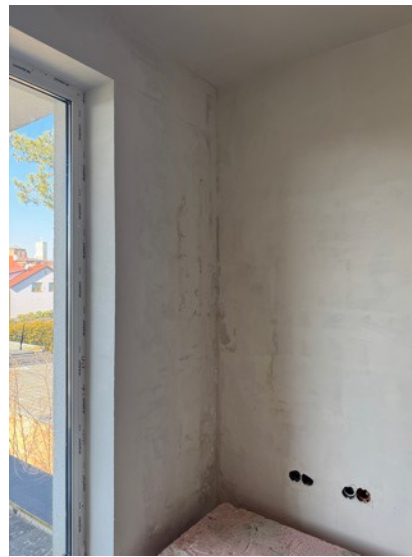
2.OG Top 6 – Wohnküche Wasserschaden
