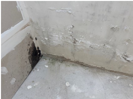
DG Top 9 – Zimmer, Feuchtigkeitsschaden
