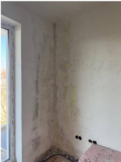
1.OG Top 3 – Wohnküche Wasserschaden
