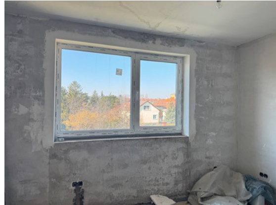
2.OG Top 7 – Zimmer, Wasserschaden
