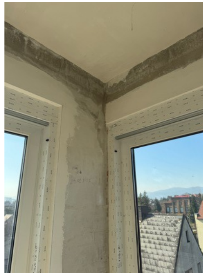
DG Top 9 – Wohnküche, Wasserschaden
