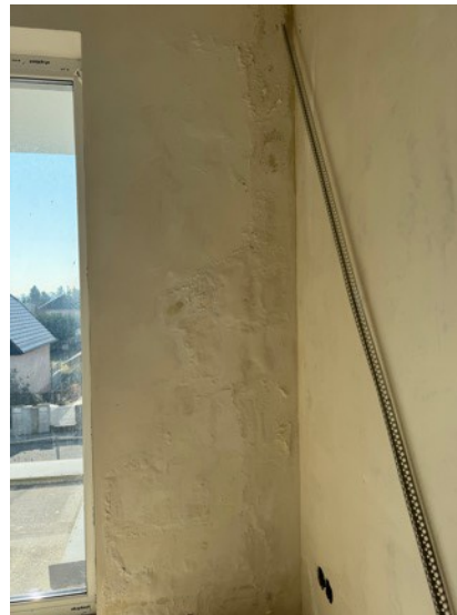
2.OG Top 8 – Wohnküche, Wasserschaden
