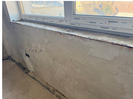
1.OG Top 4 – Zimmer Wasserschaden
