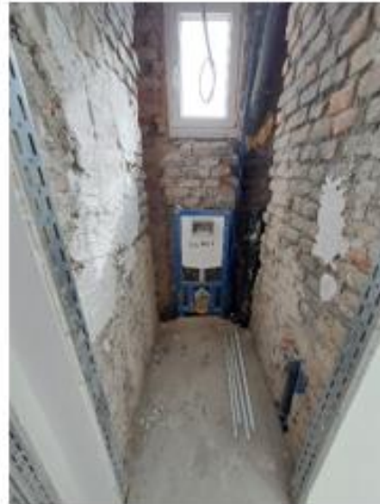
Unterputzspülkasten in ehemaligem Gang-WC
