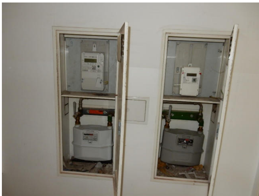
Foto 23: Zählernischen am Gang (Strom- und Gaszähler für W 9 und W 10)
