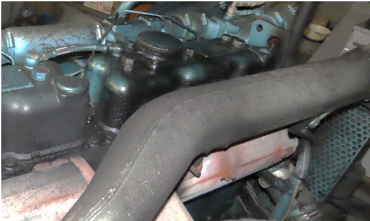
Abbildung 50 austretendes Öl mit darunter angebrachter unisolierter Abgasleitung
