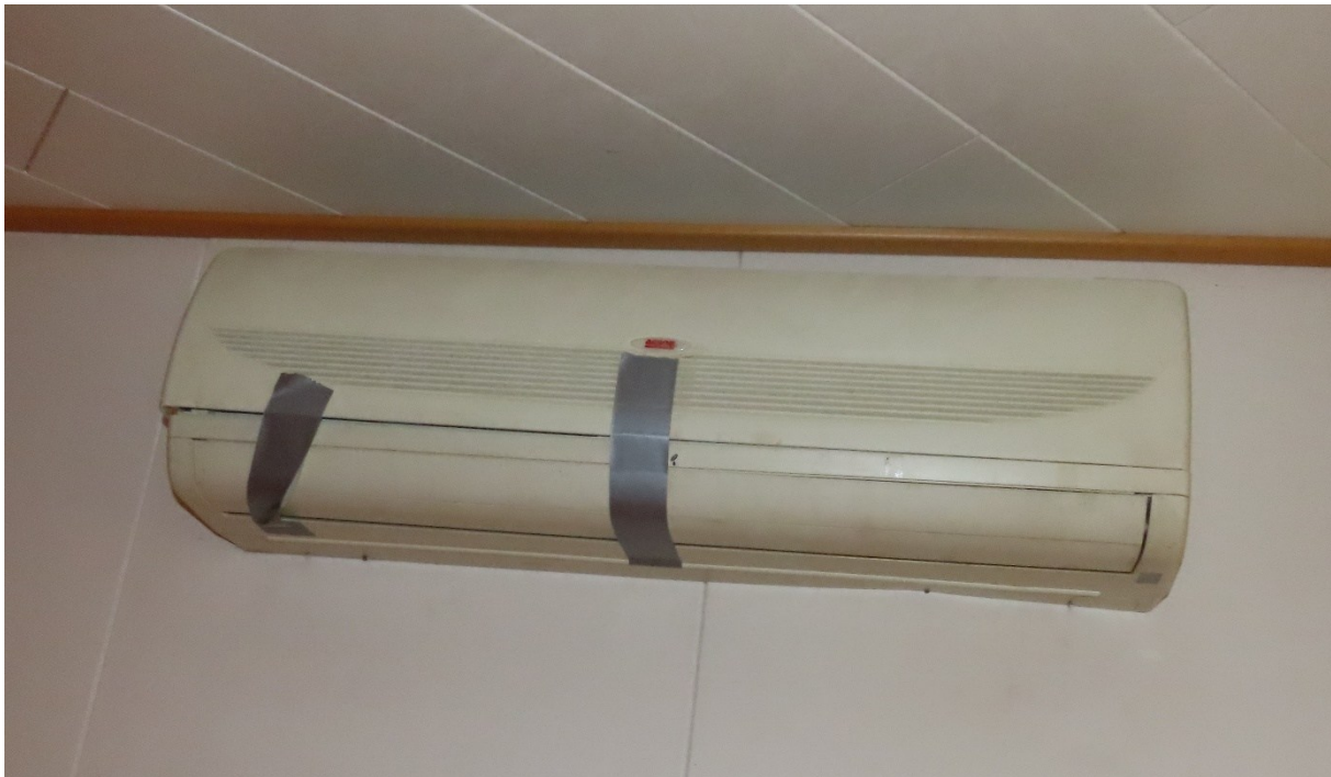
Abbildung 76 defekte Klimaanlage in der Lotsenwohnung
