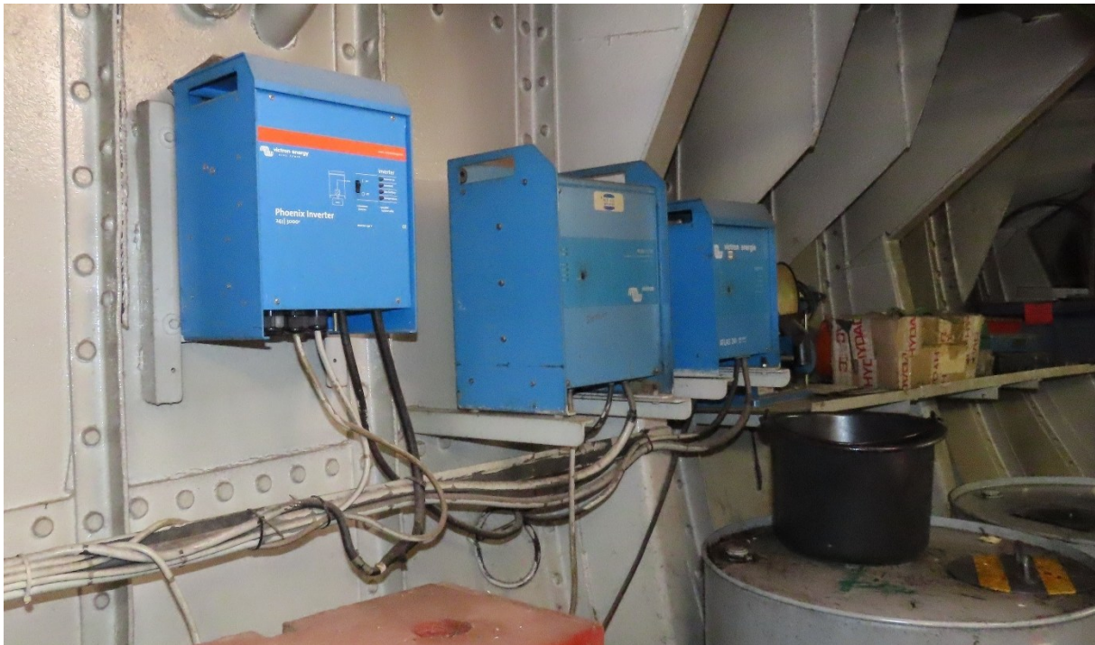
Abbildung 31 elektrische Umformer, zwei von den drei Umformern defekt.
