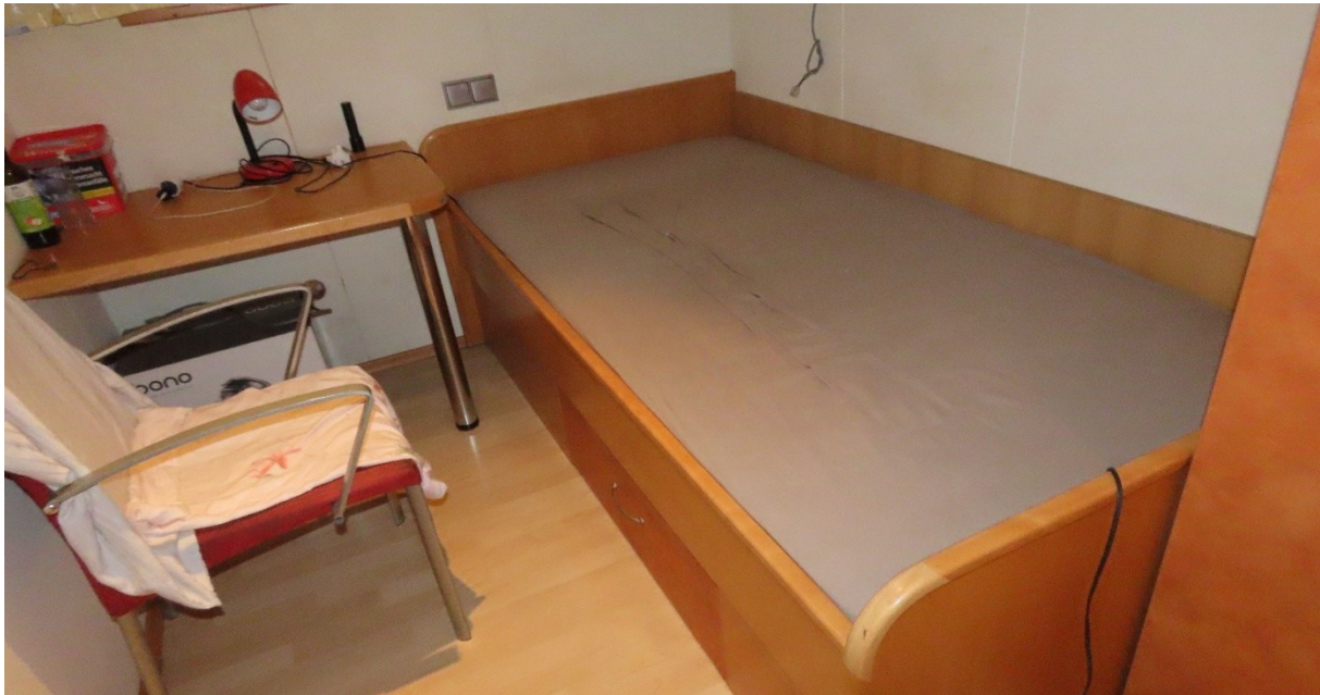
Abbildung 77 Zustand mittlere Kammer; fehlende Wandleuchte
