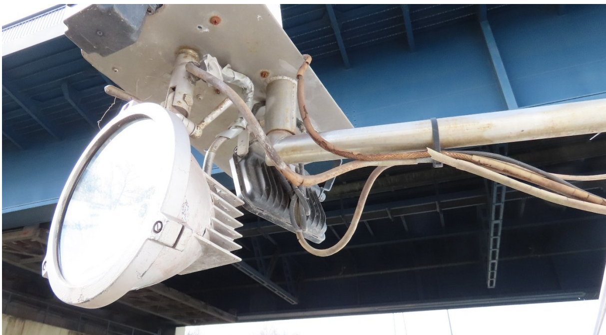
Abbildung 41 geflicktes Kabel an der Stb.-seitigen Suchscheinwerfer
