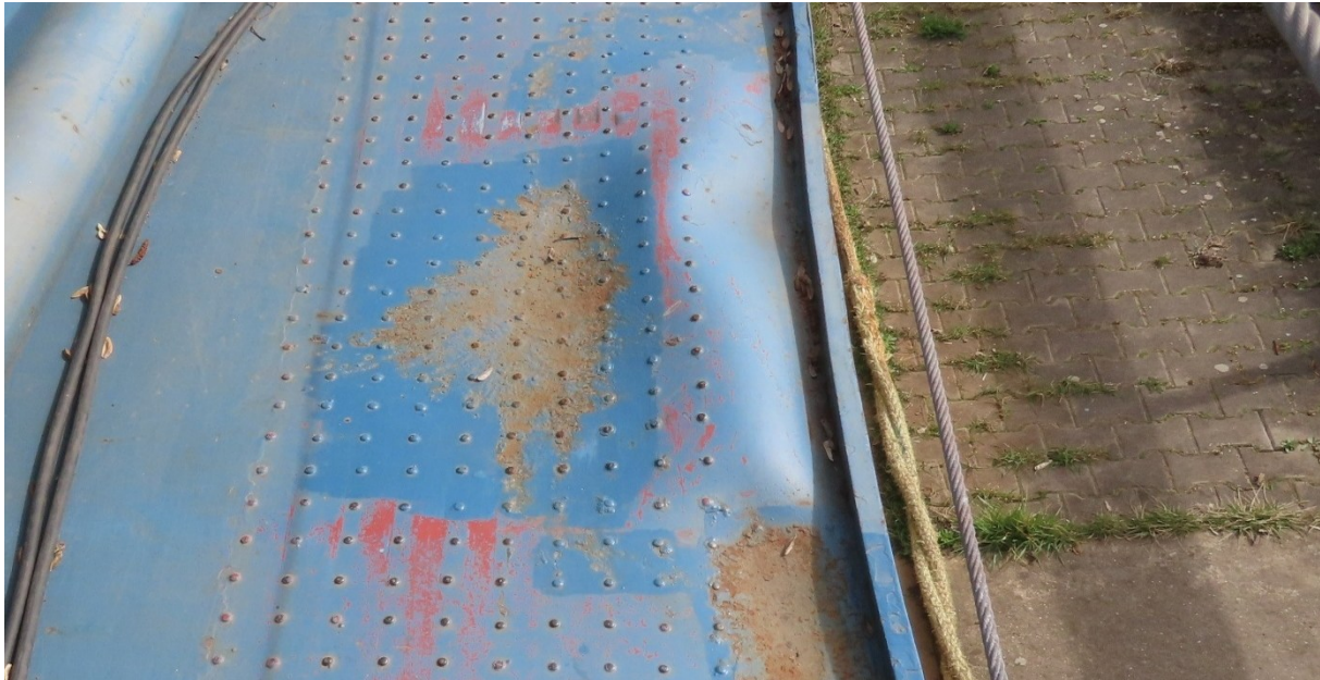
Abbildung 44 stb.-seitiges Gangbord mit Verformung
