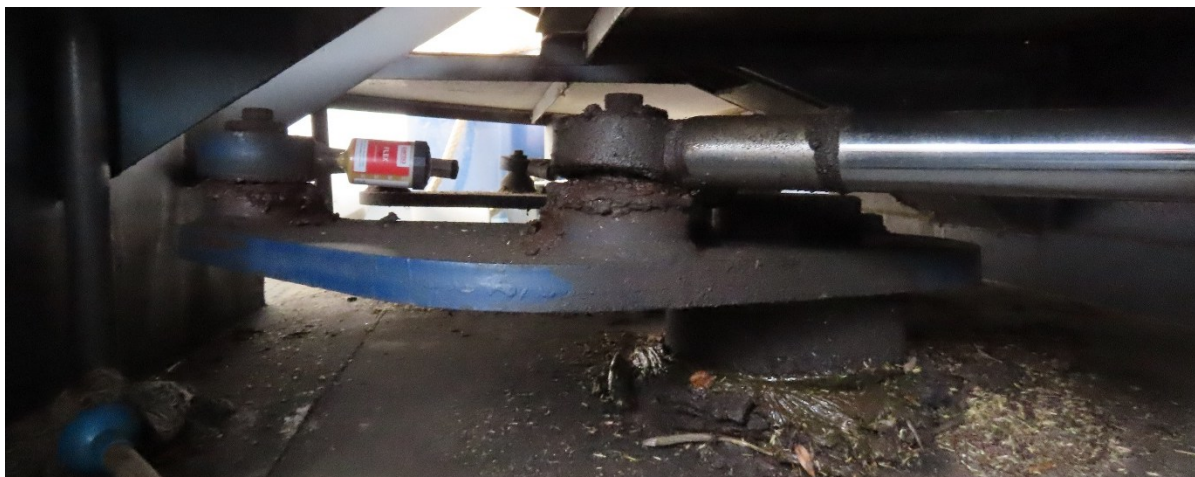
Abbildung 36 Zustand der Rudieranlage
