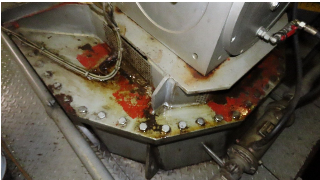
Abbildung 52 Getriebeöl bis auf die Bodenbeplattung
