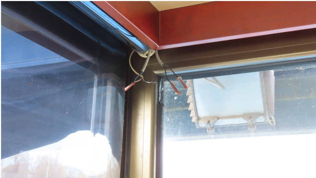
Abbildung 16 Anschlusskabel des elektrischen Rollladens hängt aus der Decke
