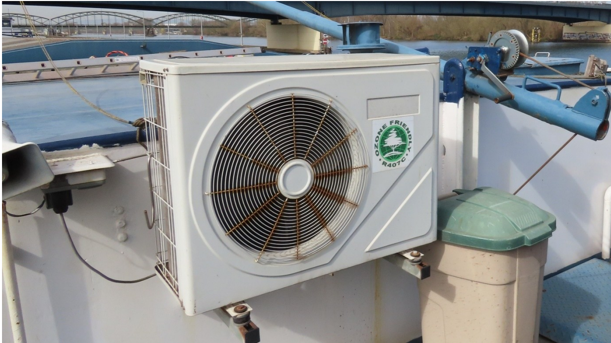
Abbildung 59 Außeneinheit der Klimaanlage
