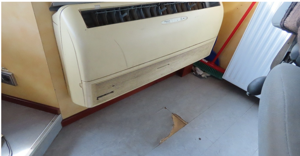
Abbildung 7 defekte Klimaanlage im Steuerhaus
