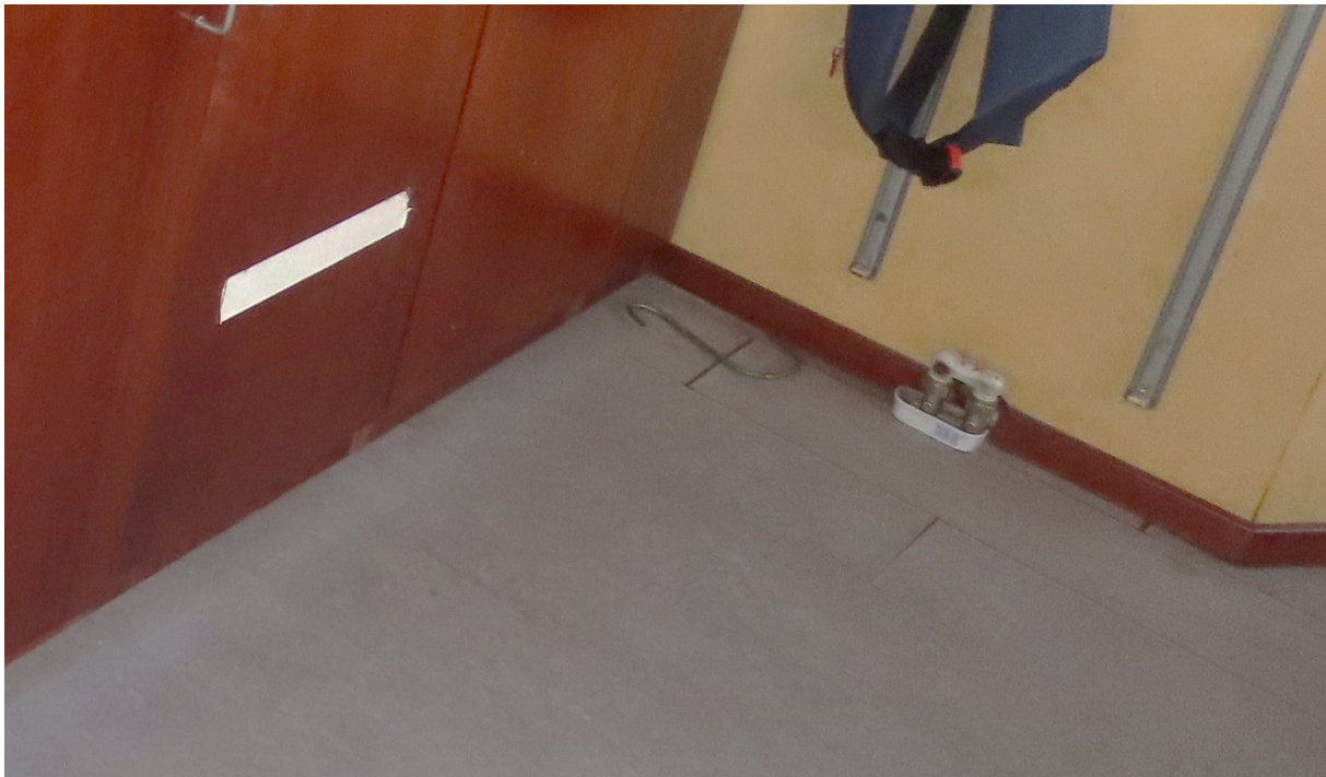
Abbildung 8 Heizkörperanschluss des zweiten defekten Heizkörpers
