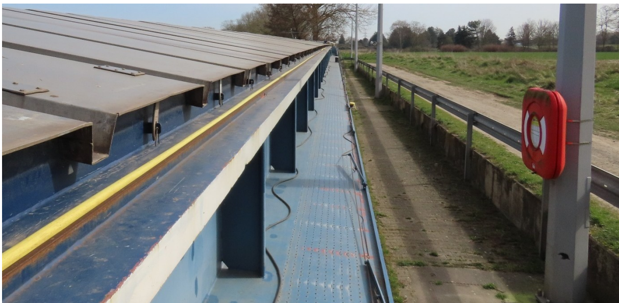
Abbildung 43 Zustand Gangbord stb.-seitig
