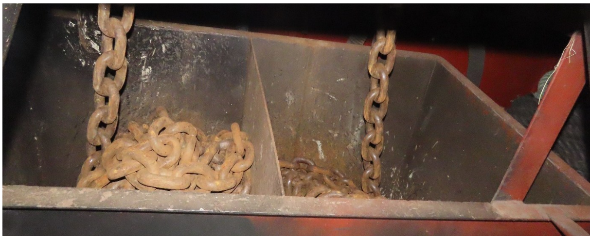
Abbildung 62 Zustand Konservierung Kettenkästen
