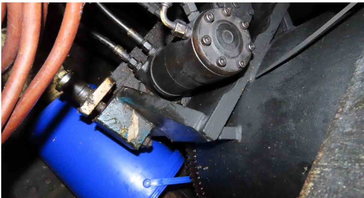
Abbildung 34 Hydraulikanlage des Autokrans
