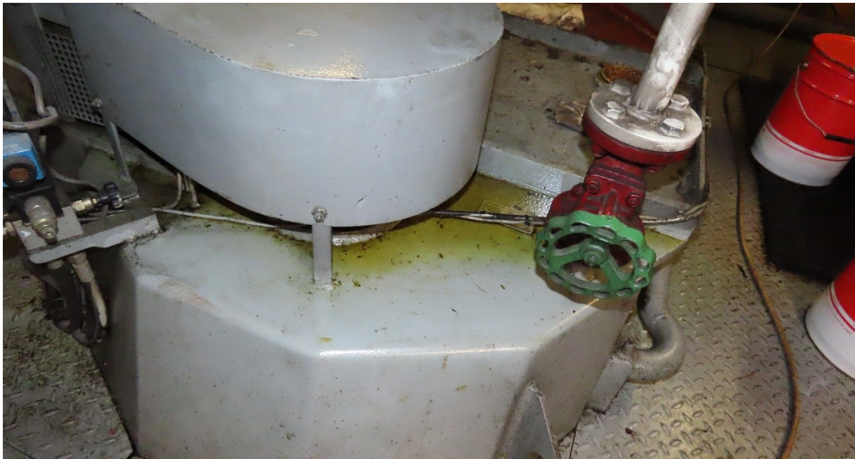
Abbildung 51 Undichtigkeiten am Umlenkgetriebe
