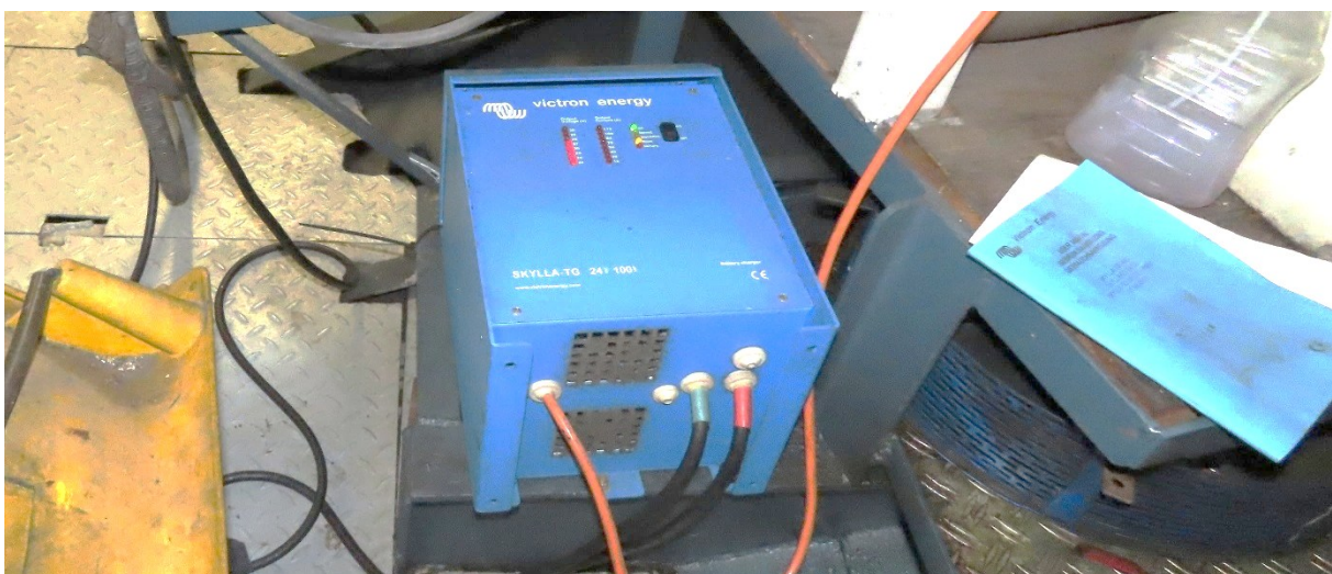
Abbildung 32 provisorisch installierter Stromumformer
