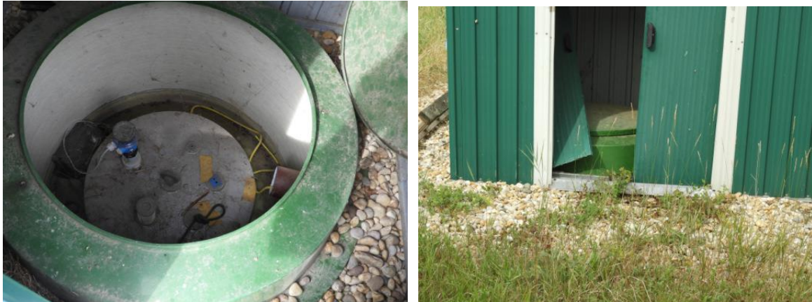
Abbildung 13; Anschlussstelle für mobile Wasserbetankung
