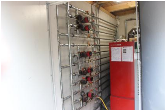
Bild 12: Fehlende Isolierung der Heizungsrohre
