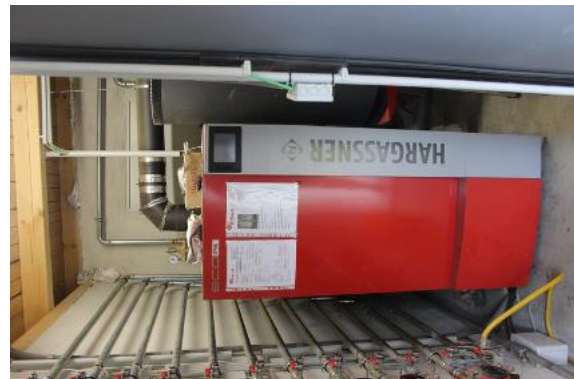
Bild 11: Fehlende Leitungen im Heizhaus
