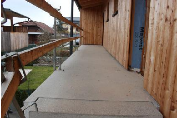
Bild 6: Zugang zu den Wohnungen im 1. Stock Top 7 und Top 8, Zugang errichtet, Absturzsicherung (Gelände) fehlt
