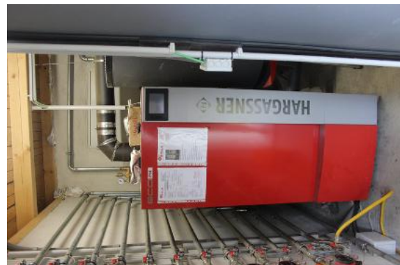
Bild 12: Fehlende Leitungen im Heizhaus
