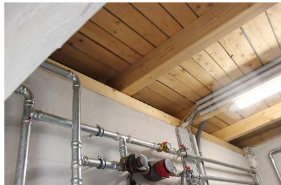
Bild 14: Brandabschottung vom Heizhaus zum angrenzenden Carport fehlt gänzlich
