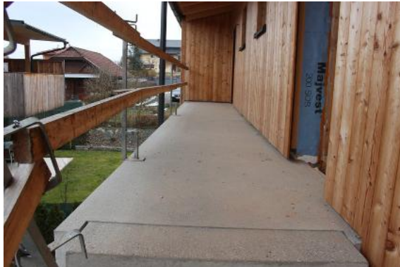
Bild 7: Zugang zu den Wohnungen im 1. Stock Top 7 und Top 8, Zugang errichtet, Absturzsicherung (Gelände) fehlt
