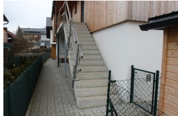
Bild 8: Zugang zu den Wohnungen im 1. Stock Top 7 und Top 8, Zugang errichtet, Absturzsicherung (Gelände) fehlt
