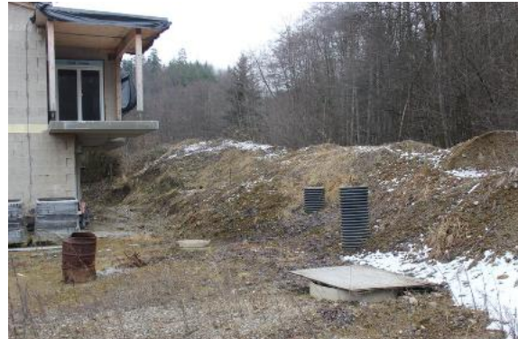
Bild 10: Im Bereich der Gebäude D und E befindet sich noch Aushubmaterial, welches zu entsorgen ist - geschätztes Volumen ca. 2.500 m 3
