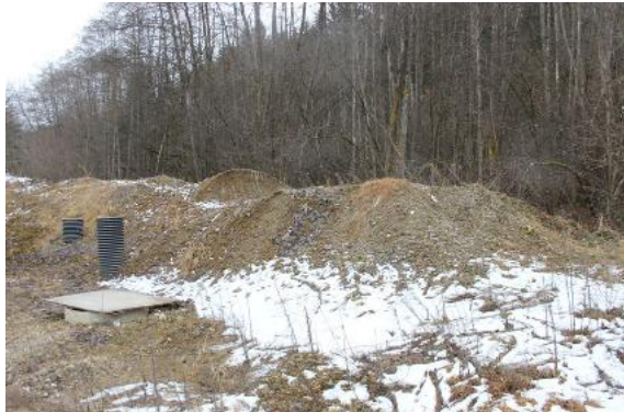
Bild 9: Im Bereich der Gebäude D und E befindet sich noch Aushubmaterial, welches zu entsorgen ist - geschätztes Volumen ca. 2.500 m 3
