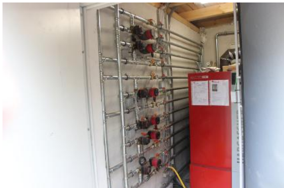
Bild 13: Fehlende Isolierung der Heizungsrohre
