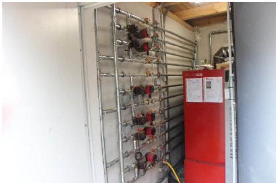
Bild 9: Fehlende Isolierung der Heizungsrohre
