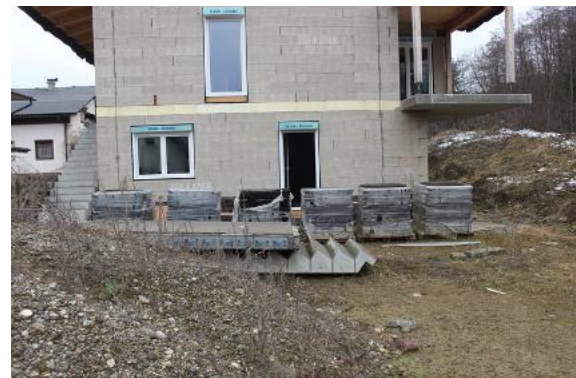
Bild 4: Dachziegel nicht eingedeckt, lagern auf der Baustelle
