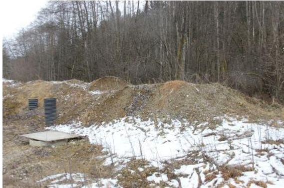
Bild 5: Im Bereich der Gebäude D und E befindet sich noch Aushubmaterial, welches zu entsorgen ist - geschätztes Volumen ca. 2.500 m 3
