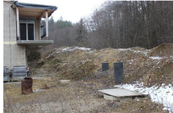
Bild 2: Im Bereich der Gebäude D und E befindet sich noch Aushubmaterial, welches zu entsorgen ist - geschätztes Volumen ca. 2.500 m 3
