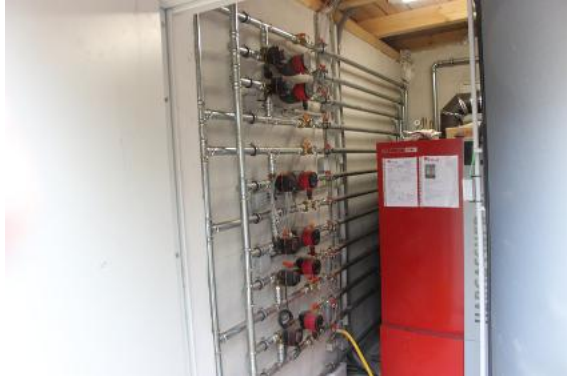
Bild 5: Fehlende Isolierung der Heizungsrohre
