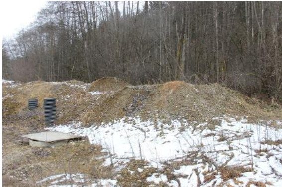
Bild 1: Im Bereich der Gebäude D und E befindet sich noch Aushubmaterial, welches zu entsorgen ist - geschätztes Volumen ca. 2.500 m 3
