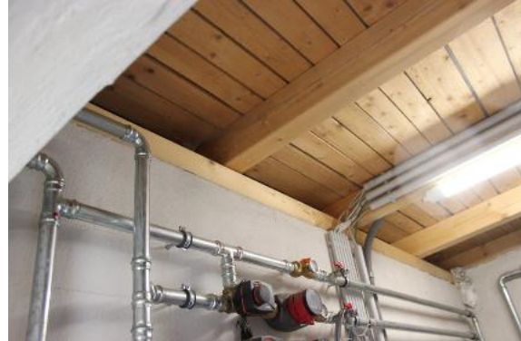
Bild 6: Brandabschottung vom Heizhaus zum angrenzenden Carport fehlt gänzlich
