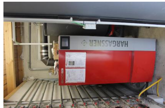
Bild 4: Fehlende Leitungen im Heizhaus
