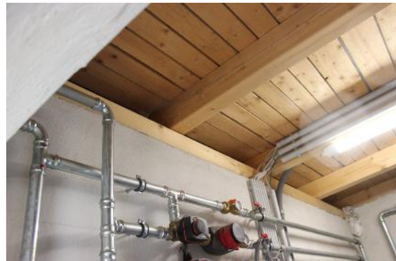
Bild 10: Brandabschottung vom Heizhaus zum angrenzenden Carport fehlt gänzlich
