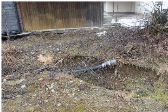
Bild 3: Nahwärme der Pelletsheizung
