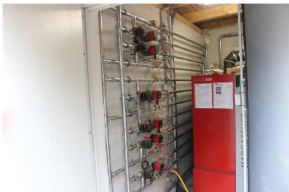
Bild 9: Fehlende Isolierung der Heizungsrohre
