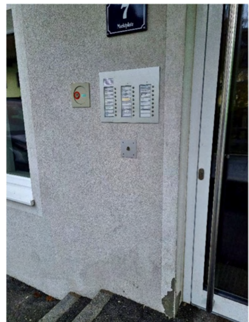
Bild 4 von 32 Blick auf das Klingeltableau und auf Putzabblätterungen an der Fassade
