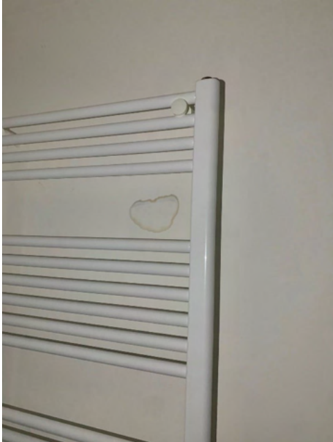
Bild 25 von 32 Blick auf den Handtuchheizkörper und eine Feuchtigkeitsschädigung im Bad
