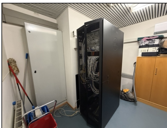
Hinterer Gebäudeteil Technik- und Lagerraum
