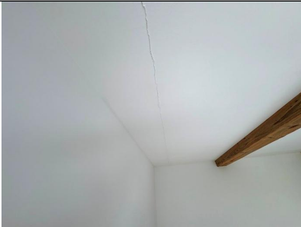
Abbildung 79: Top W 5 (M7) – Bsph. Risse
