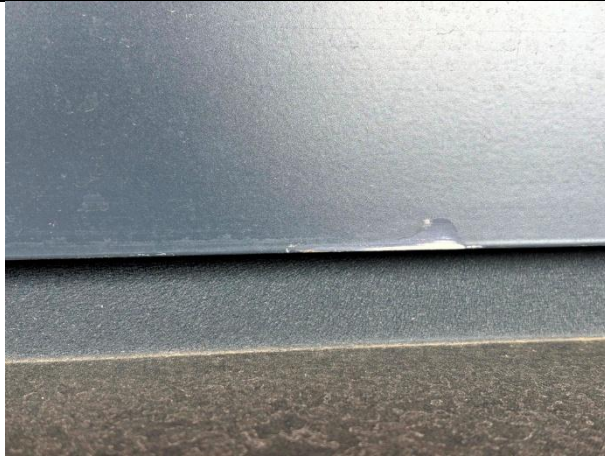
Abbildung 120: Bsp. beschädigte Alu-Fensterbank
