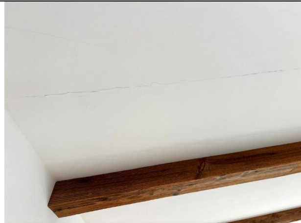
Abbildung 80: Top W 5 (M7) – Bsph. Risse
