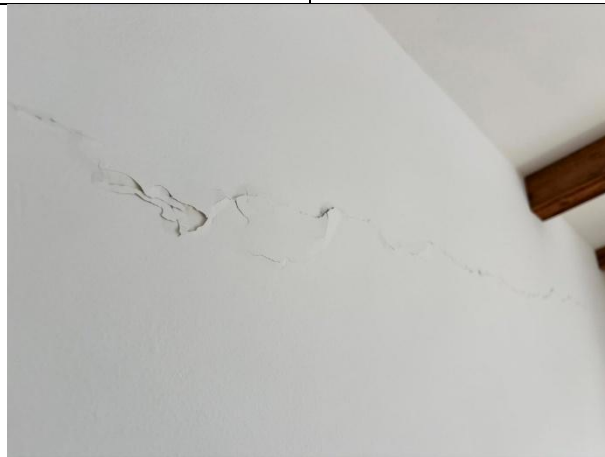
Abbildung 81: Top W 5 (M7) – Bsph. Risse
