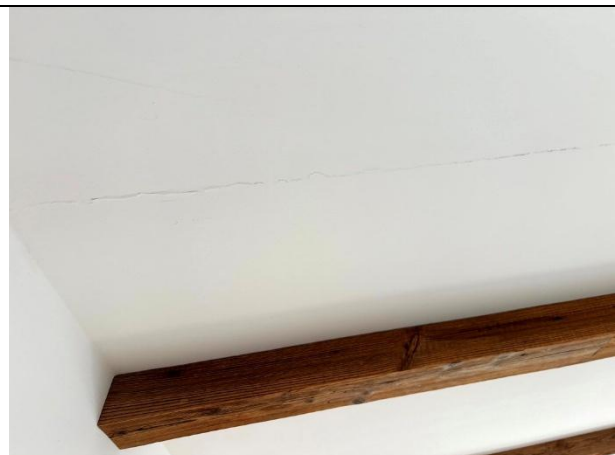
Abbildung 77: Top W 5 (M7) – Bsph. Risse
