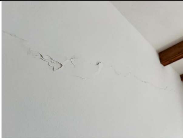
Abbildung 78: Top W 5 (M7) – Bsph. Risse
