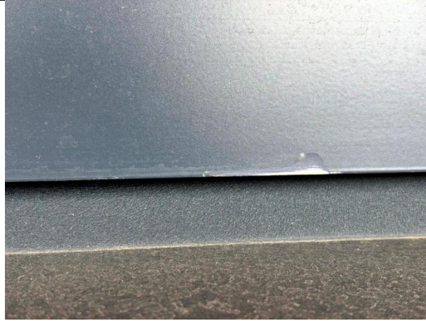
Abbildung 117: Bsp. beschädigte Alu-Fensterbank
