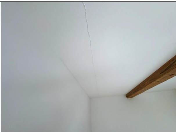
Abbildung 76: Top W 5 (M7) – Bsph. Risse
