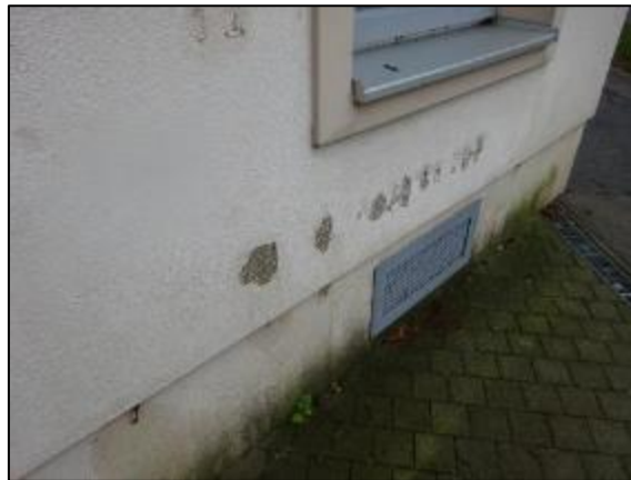
Abbildung 44: Fasadenschäden im Zutrittsbereich des Müllraums (Teil 2)
