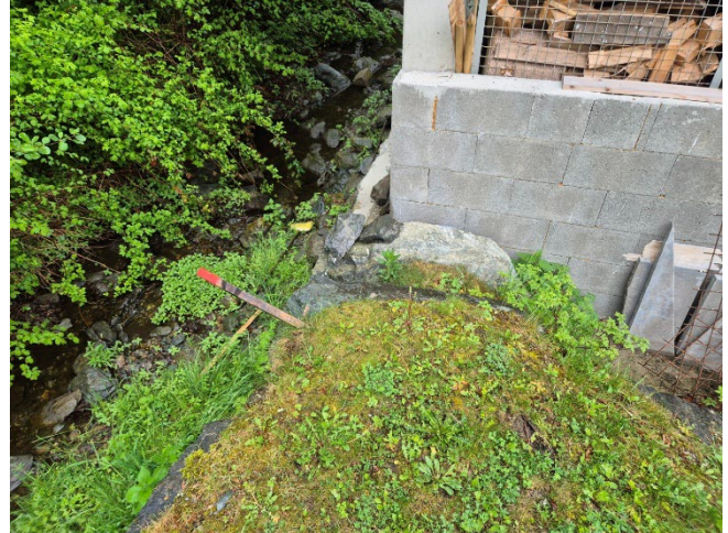
Abbildung: Eventueller Grenzüberbau
