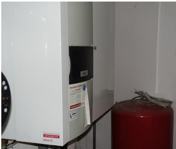
Abbildung: Haustechnik (Gastherme - Heizungsanlage)
