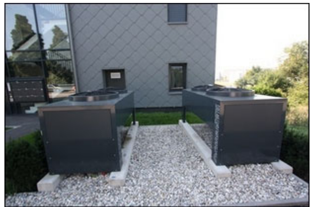
Abb.4 Ansicht Vorgarten Südwest, Equipment Wärmepumpe
