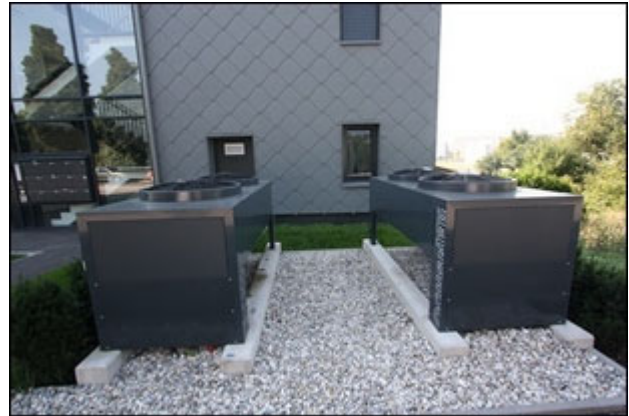
Abb.4 Ansicht Vorgarten Südwest, Equipment Wärmepumpe
