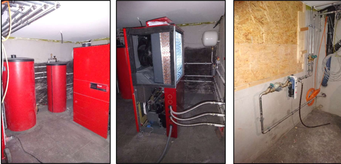
Puffer und Wärmepumpe – noch nicht komplett angeschlossen Abluft geplant
