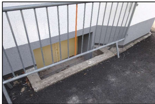
Abluftschacht für die Luft – Wärmepumpe
