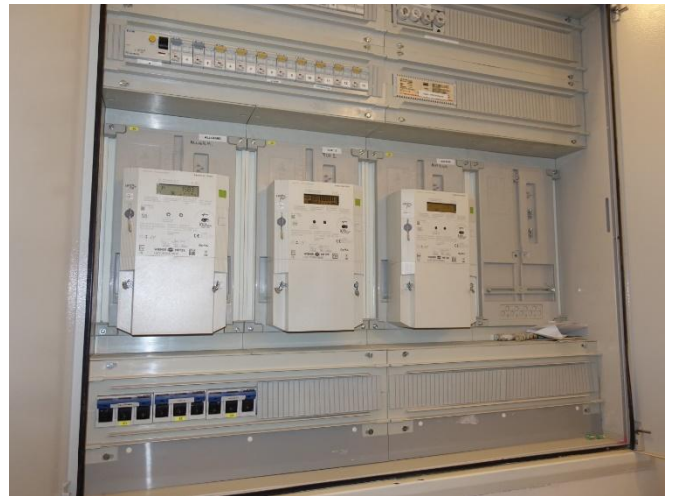
Abbildung: Stromzähler (Befundaufnahme 2024)
