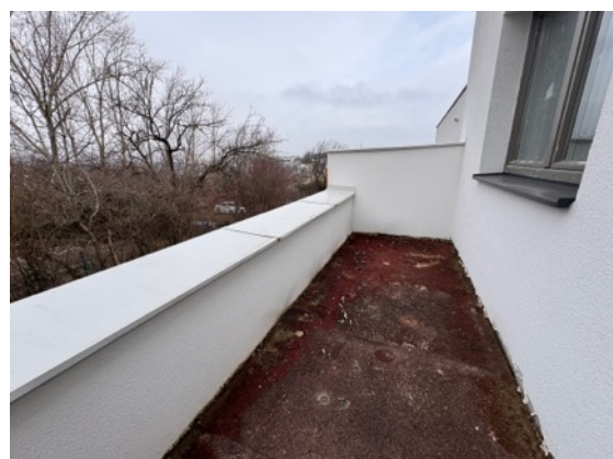
Schadhafte Abdichtung und Attika Balkon
