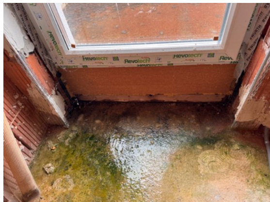
Wassereintritt aufgrund mangelhaftem Wasserabfluss Balkon
