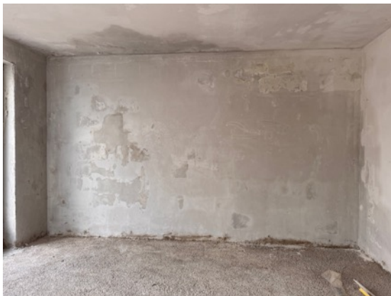
Feuchteschäden Wand und Decke
