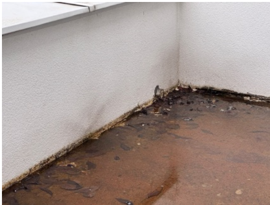
Fehlerhafter Abfluss Balkon
