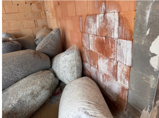
Ausblühungen Innenmauer (Stiegenaufgang)
