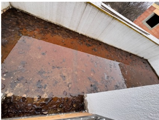
Fehlerhafter Abfluss Balkon
