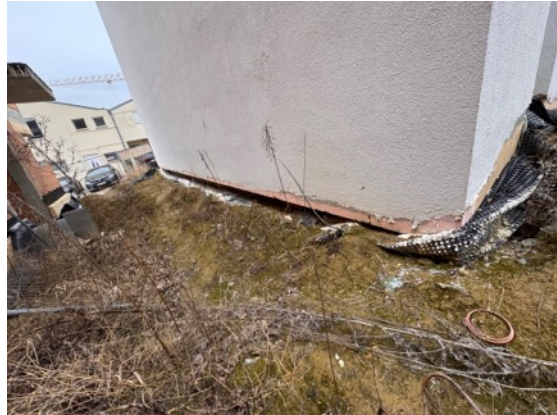
Fassadenschäden insbesondere im Sockelbereich
