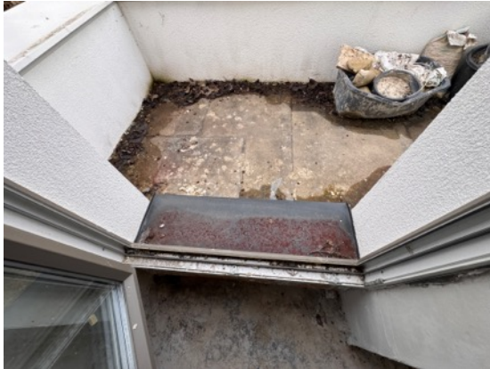
Schäden Abdichtung Balkon
