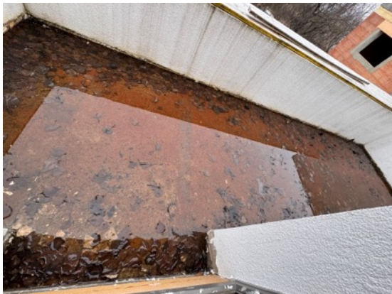
Fehlerhafter Abfluss Balkon
