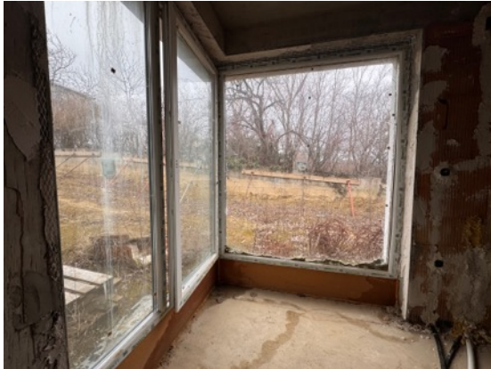
Fassadenschäden bei Terrassenfensterkonstruktion
