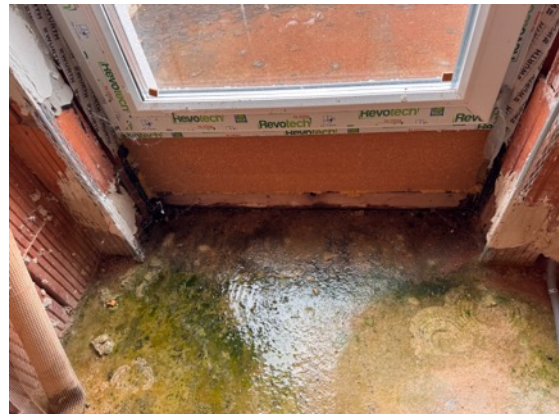
Wassereintritt aufgrund mangelhaftem Wasserabfluss Balkon
