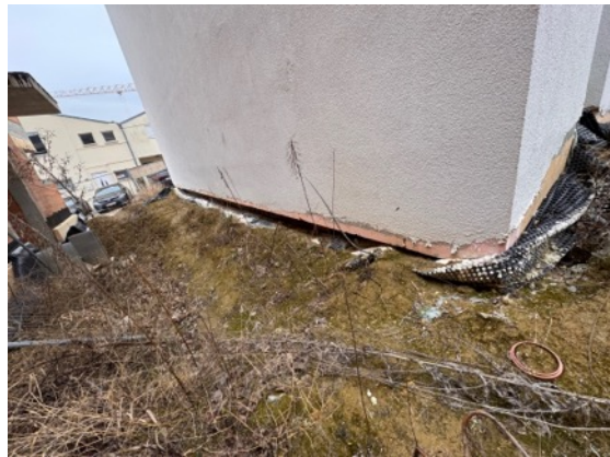
Fassadenschäden insbesondere im Sockelbereich
