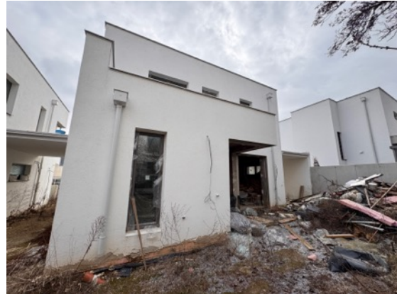
Fassadenschäden, insbesondere im Sockelbereich
