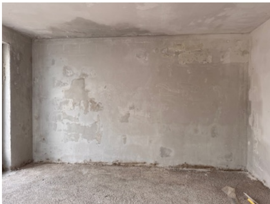
Feuchteschäden Wand und Decke
