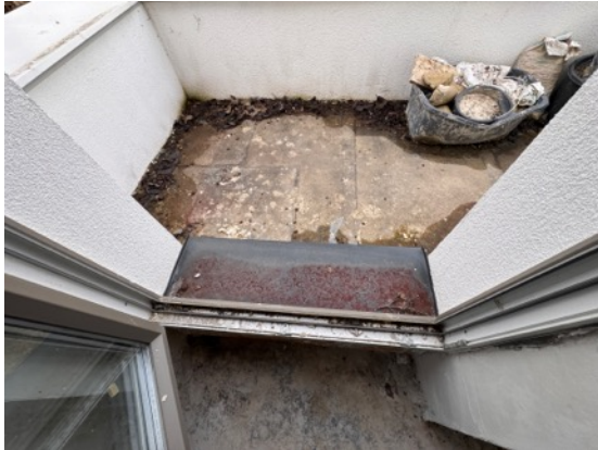
Schäden Abdichtung Balkon
