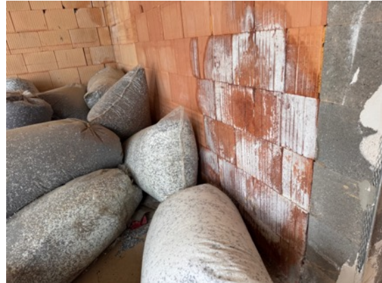
Ausblühungen Innenmauer (Stiegenaufgang)
