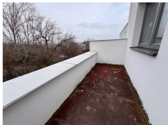
Schadhafte Abdichtung und Attika Balkon
