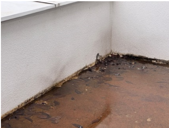
Fehlerhafter Abfluss Balkon
