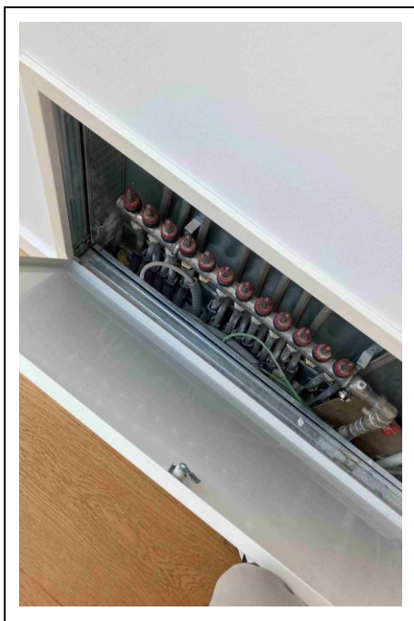
Heizkasten für Fußbodenheizung
