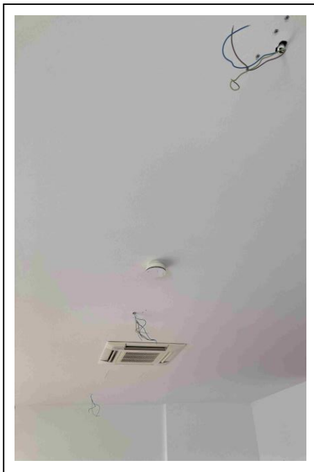
Kabel und Klimagerät
