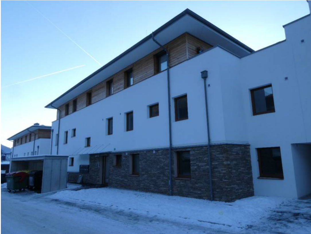
Nordwestansicht Bauteil B (Die teilweise fehlenden Fensterbänke werden laut Angabe von Herrn Aberger im 1. Quartal 2026 montiert)
